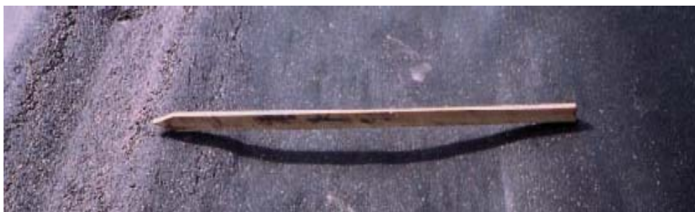
Foto 4.2: Ahuellamiento o deformación permanente o rutting
